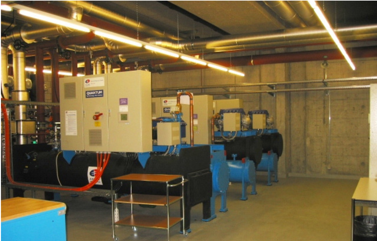
Kältezentrale mit 3 Quantum Kältemaschinen 2x 600 kW und 1x 900 kW
